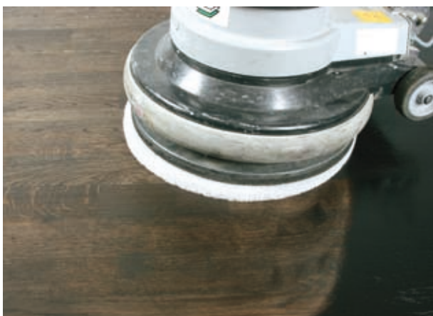
8) Mekanisk påføring og polering av Osmo Color Oil med hvit pad og enskivemasnin
